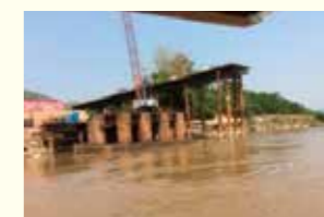
メコン川に建設中の鉄橋。 一帯一路構想で中国化の進むラオス
